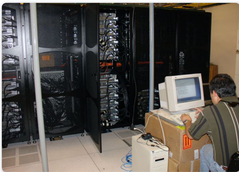
► Figura 19. Las diferentes tecnologías en un mismo datacenter pueden complicar su mantenimiento e impedir que evolucione óptimamente.
