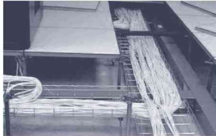
Figura 9.5. Cableado de red distribuido por un falso suelo
