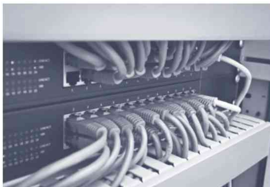
Figura 9.7. Dos switches en funcionamiento en una red local Ethernet
