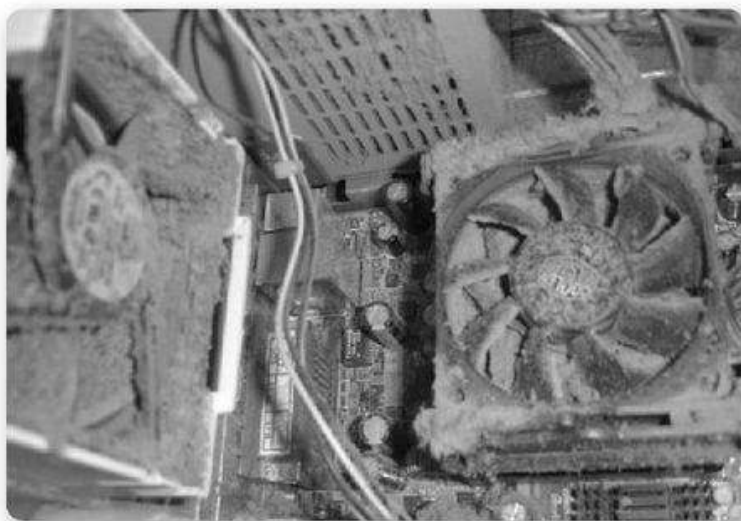
► Figura 8. La acumulación excesiva de polvo dentro del gabinete puede elevar la temperatura y producir cortocircuitos.
