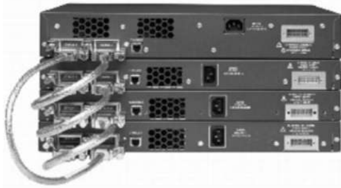
Fig. 2-5 Switchs en stack.
