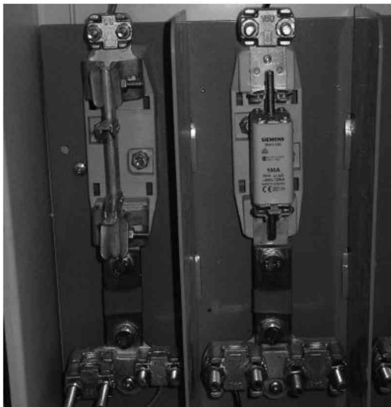
Figura 8.2. Detalle de la conexión del neutro y de un fusible de una CGP de base abierta
