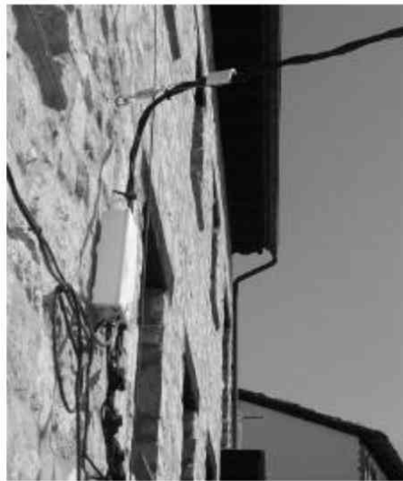
Figura 7.6. Detalle de acometida tensada
