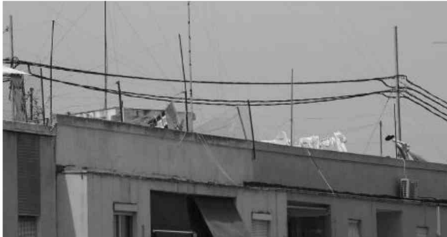
Figura 7.5. Vista de una red aérea tensada de BT
