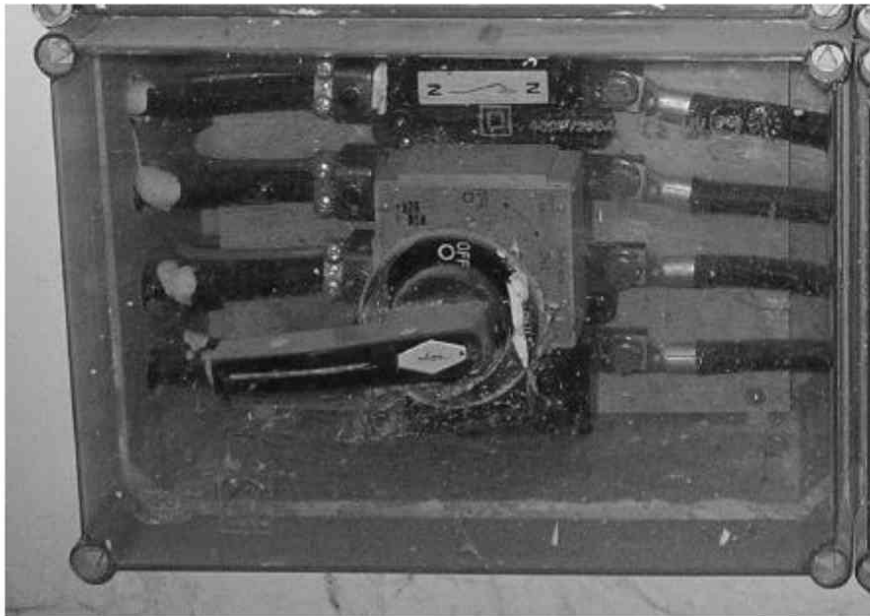
Figura 10.2. Interruptor General de Maniobra
