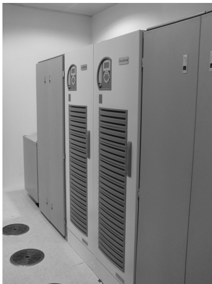
Figura 7.27. 2 SAI Inline paralelos junto a un generador.
