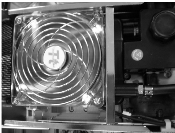
Figura 5.94. Refrigeración líquida funcionando.
