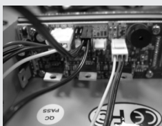
Figura 5.110. Detalle del conexionado del fan control.
