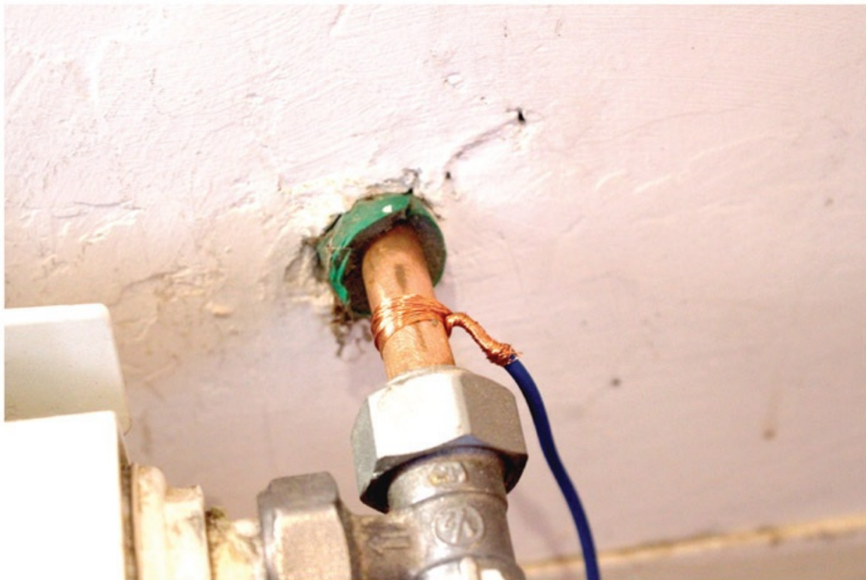
Figura 11.37 – Toma de tierra realizada sobre el tubo de un radiador.
