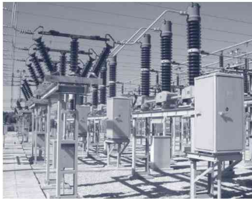
Figura 6.10. Subestación de transformación
