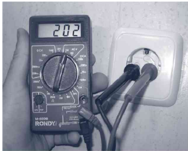
Figura 9.8. Medida de la tensión alterna de una toma de corriente de 220 V
