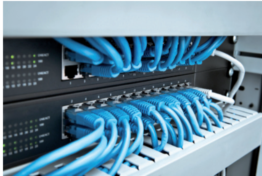
Figura 6.7. Dos switches en funcionamiento en una red local Ethernet
