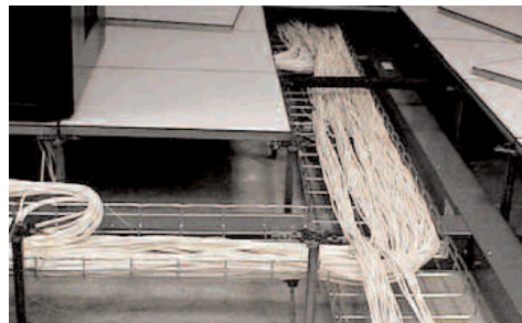
Figura 6.5. Cableado de red distribuido por un falso suelo
